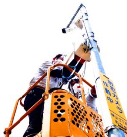
写真は保守点検の様子。防犯カメラは24時間稼働。犯罪抑止効果は大きい。
